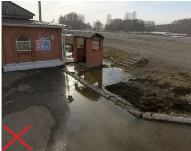
Недопустимо отсутствие водоотведения с территории ОДС, пешеходная зона не должна подтапливаться талыми водами и после осадков. Необходимо организовывать мероприятия по регулированию стоков.
